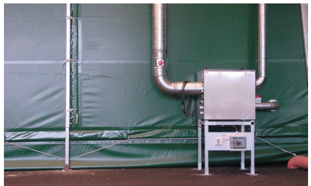
Un déshumidificateur de DST de type Recusorb DR-40 installé dans un hall de stockage en PVC
